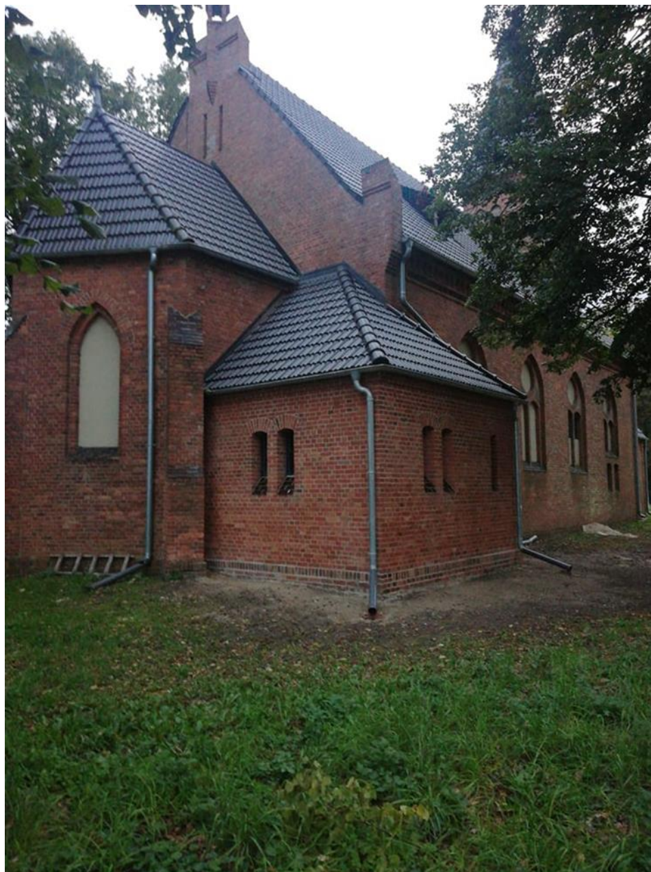
Wykonanie prac konserwatorskich, restauratorskich i robót budowlanych w budynku kościoła ewangelickiego w Ryczywole (odbudowa zakrystii).
